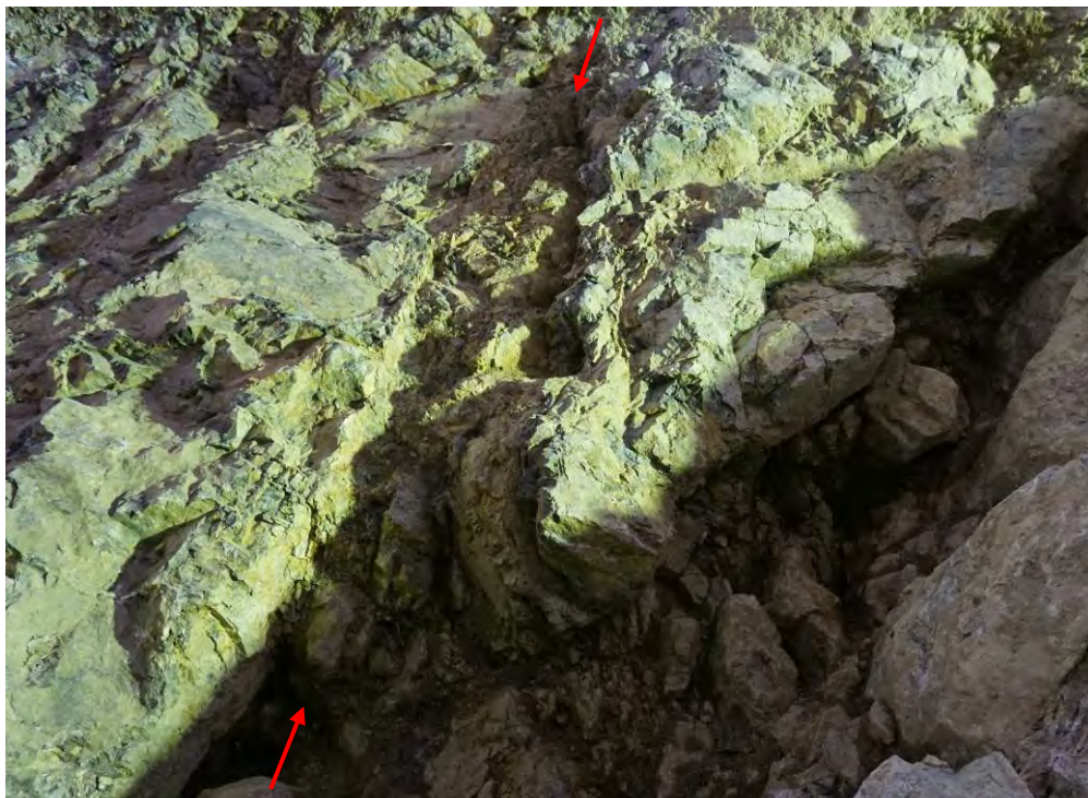
写真- 3.1.38 No.133 付近の底盤部 割れ目沿いに幅の狭い CLl 級岩盤が分布する。
