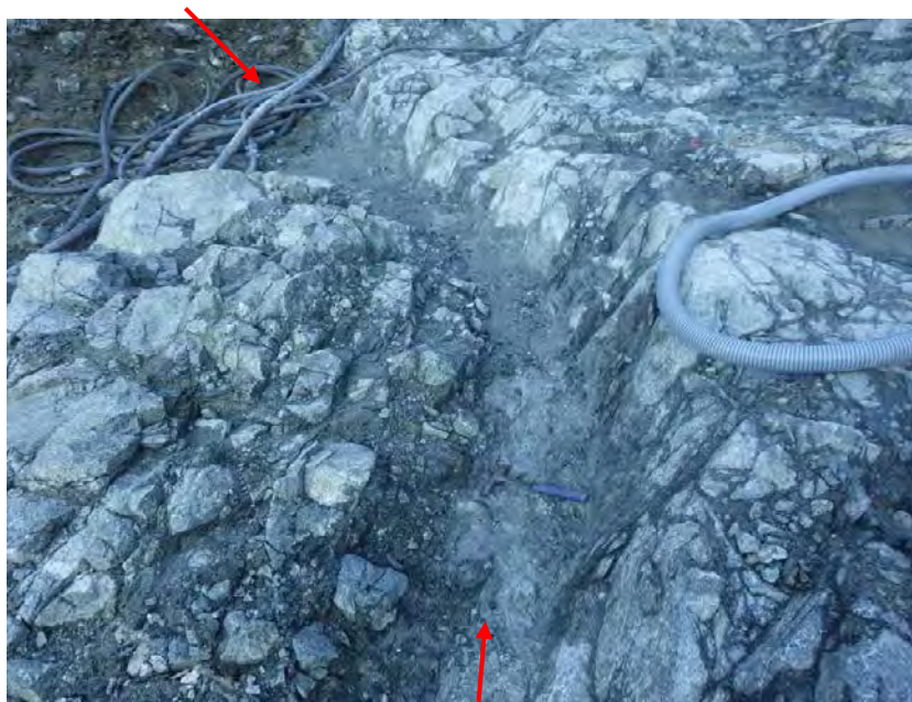
写真- 3.1.2 監査廊部の F-6 断層 幅 3cm～5cm 程度の灰色粘土部を含む CL1 級岩盤が幅 30cm 程度で分布する。
