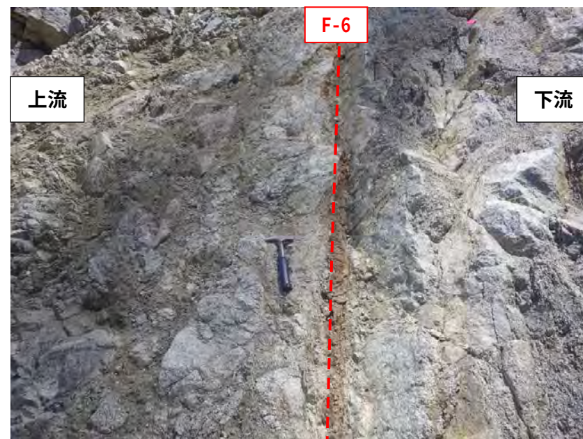
P.1 F-6 断層 幅 10cm 程度の灰色粘土部を伴う。 断層より下流側は CLh 級岩盤～CM 級岩盤主体となる。
