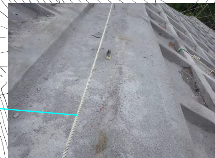
小段部に連続するクラックが発生
