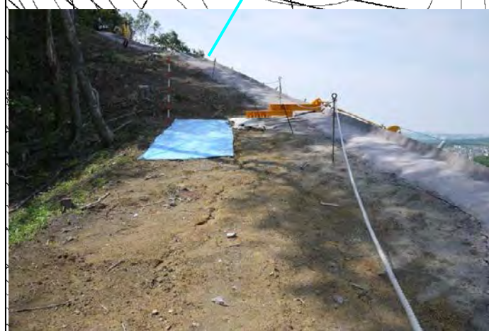
頭部：尾根部に連続するクラックが発生
