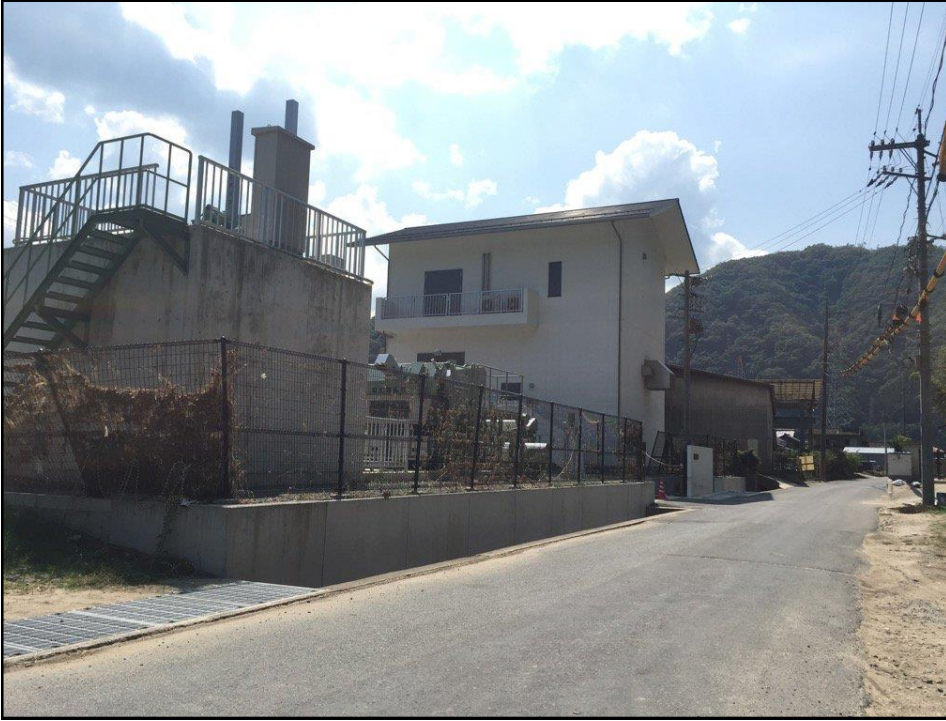
備中広瀬駅近くの 真新しい排水ポンプ 場（高梁市松山）も 浸水。 周辺の集落も甚大 な浸水被害。
