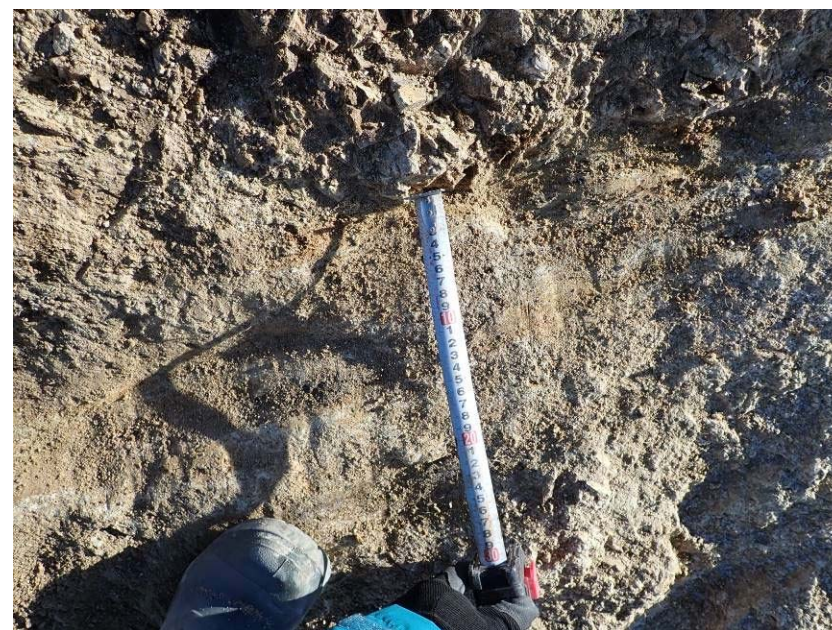
Pic. 2 F-13 断層の近接写真
