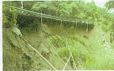
道路法面倒壊(国道 176 号(与謝野町))
